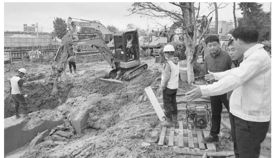
윤병태 나주시장은 21일 삼영지구 우수저류시설 설치 공사장 인근 상수도관 파손 현장을 즉각 방문해 주민 생활불편 최소화를 위한 복구, 물 공급에 총력을 기울여 줄 것을 당부했다.
