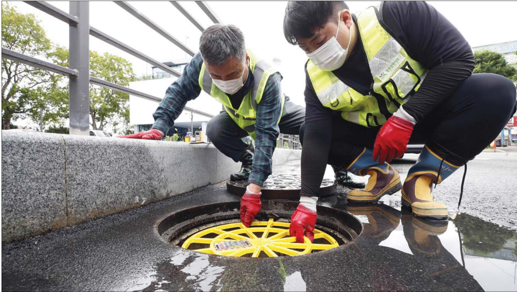
‘폭우로 인한 맨홀 추락 막자’ 안전망 점검 광주 북구청 건설과 직원들이 광주 북구 도심에서 장마철 집중호우에 대비해 설치한 맨홀 추락방지 안전망 점검을 하고 있다. /북구 제공
